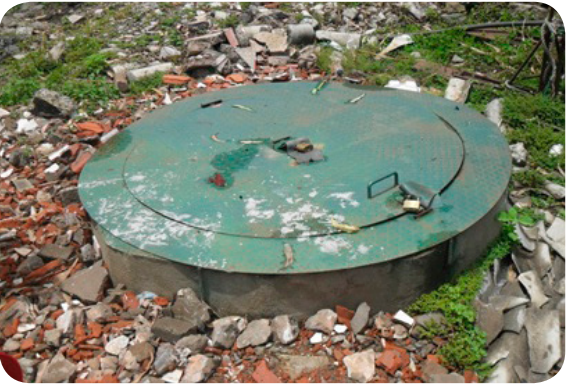
Figura 5. Aljibe ubicado en el terminal Belencito en Medellín.
